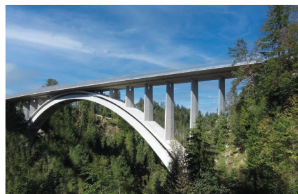
Die Echelsbacher Brücke verbindet die oberbayerischen Landkreise Weilheim-Schongau und Garmisch-Partenkirchen miteinander. Bild: Dr. Schütz Ingenieure
